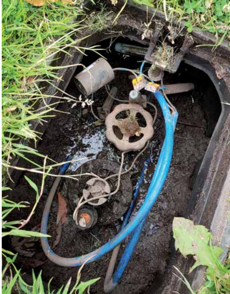
• Installation til fjernstyring af ventil i vandingsanlæg. Foto: Anders Kristoffersson.
