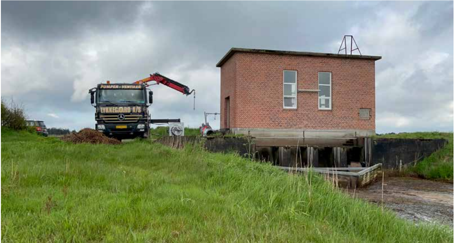
Lykkegaard monterer og servicerer pumperne rundt omkring i landets pumpehuse og stationer.
