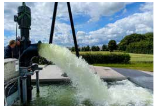
Pumperne kan pumpe mellem 25 og 5000 liter i sekunder afhængig af pumpetype - og afhængig af projektets behov. Er der behov for at pumpe mere vand, sætter man typisk flere pumper op i pumpehusene.
